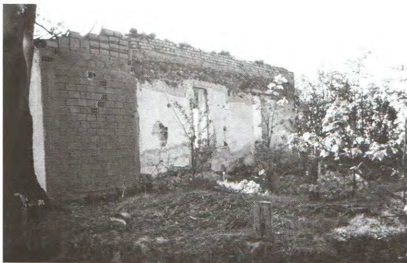
Zapaljena i oštećena džamija u Gornjoj Puharskoj
