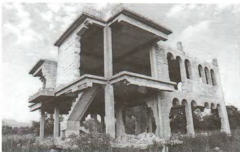
Oštećena i opljačkana džamija u Hadžićima
