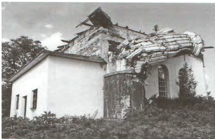
Zapaljena i oštećena džamija u Gornjim Jakupovićima
