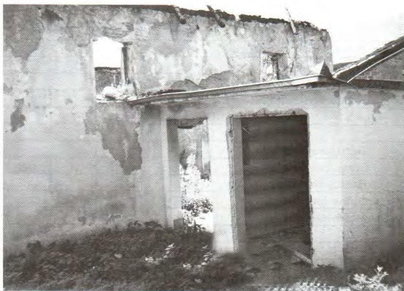
Porušena i oštećena džamija u Ališićima 562
